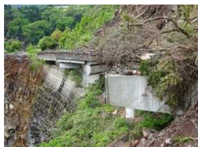
写真-1 斜面崩壊による橋梁の落橋
