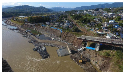
写真-2 洪水の氾濫による堤内地の橋梁の流失 8)
