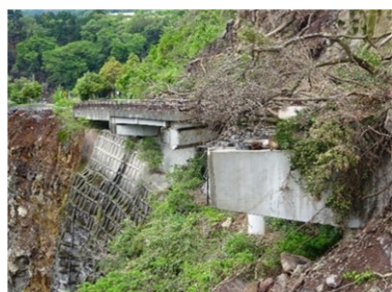
写真-1 斜面崩壊による橋梁の落橋
