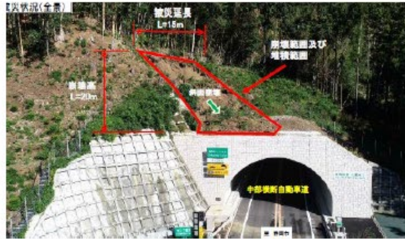
トンネル坑口の被災
