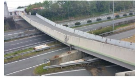
交差物件の落下による被災
