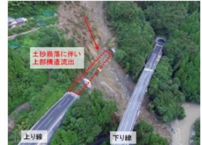
道路区域外から土砂崩落による被災
