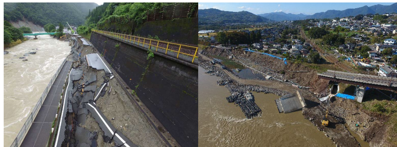
河川の洪水と道路損傷
