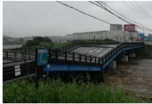
橋梁区間の被災
